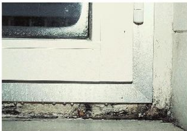
Bild 52 (D-276-2.07) Saniertes Fenster im Schlafzimmer. Heizung nur bei strenger Kälte mit mobilem Elektroofen. Deutliche Tauwasserprobleme.
