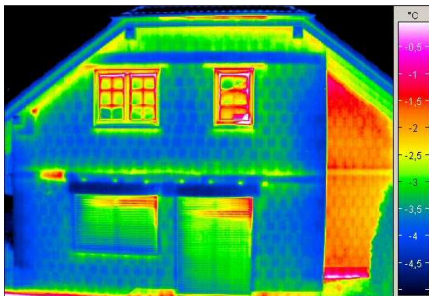
Termogram zrobiony przez kamerę wysokiej jakości
