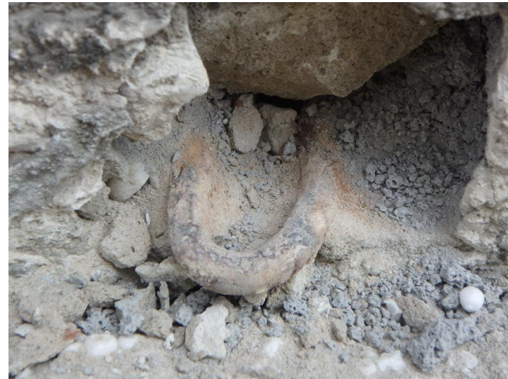
Fot. Skorodowana szpilka
