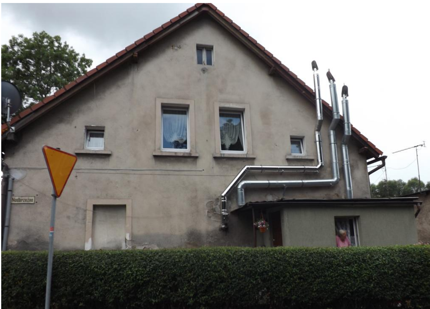
Negatywny przykłady montażu urządzeń technicznych w budynkach zabytkowych, Jelenia Góra
