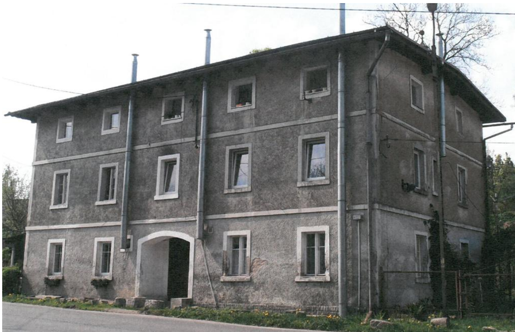
Negatywny przykłady montażu urządzeń technicznych w budynkach zabytkowych, Barcinek
