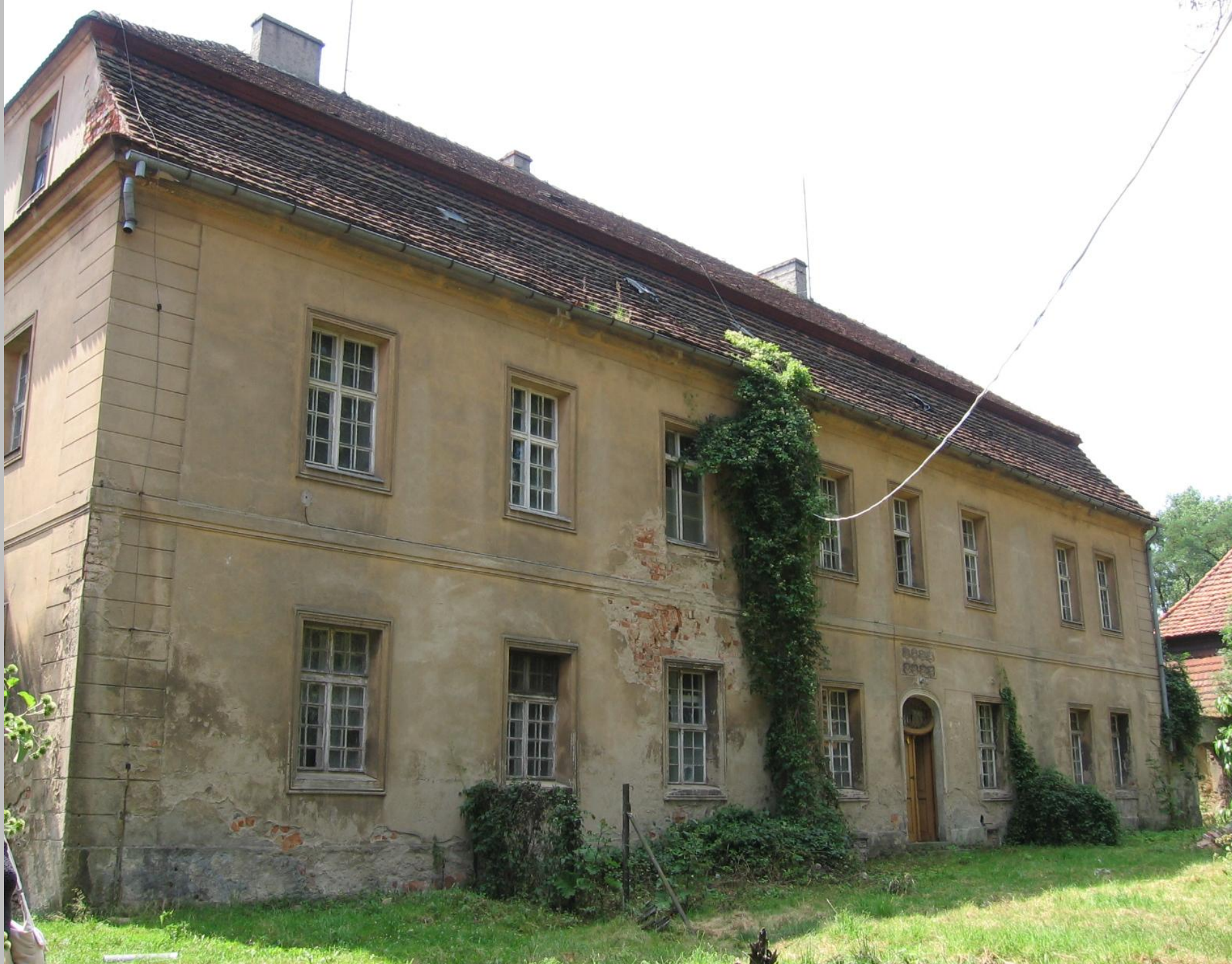
Duża Wólka, dwór renesansowy, 1570, stan przed remontem
