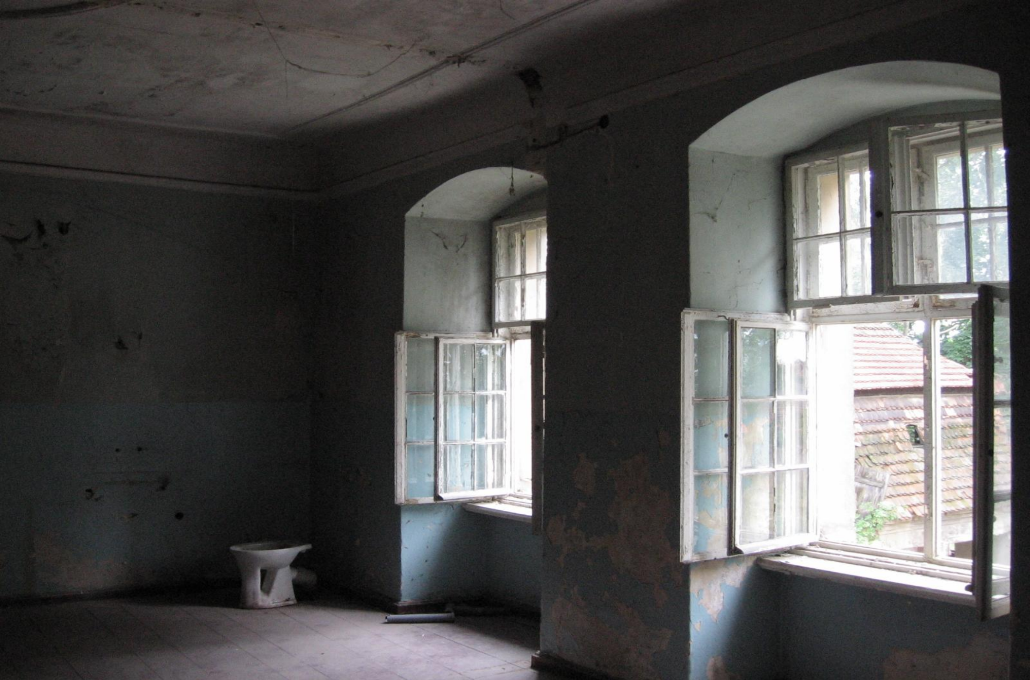
Duża Wólka, dwór renesansowy, 1570, stan przed remontem
