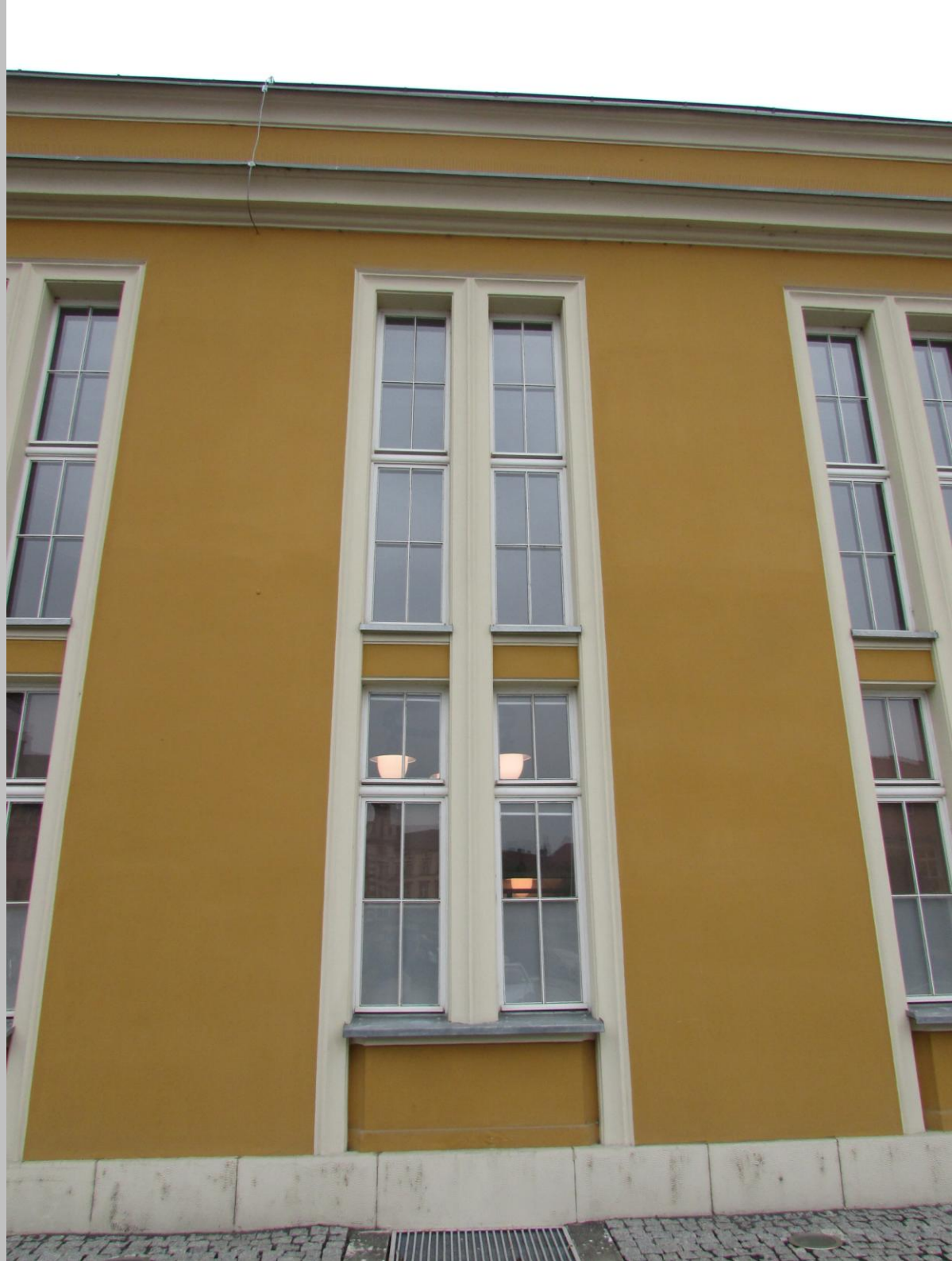
Legnica, tzw. Nowy Dworzec, stan stolarki okiennej po remoncie
