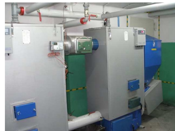
Kotłownia - stan po modernizacji
