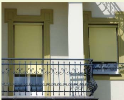
Fot. Refleksioli zamontowane na drzwiach balkonowych i oknach
